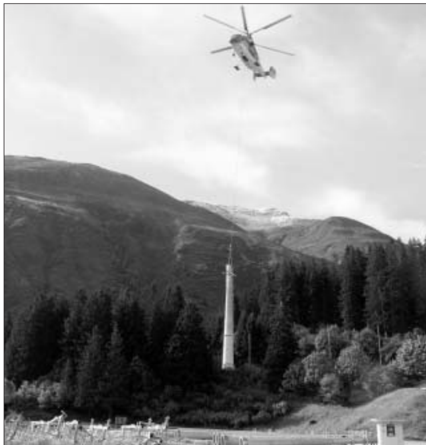
La montascha dallas petgas dalla sutgera Mulinatsch dallas Pendericas Sedrun SA succeda cun in helicopter d'aula prestaziun.
